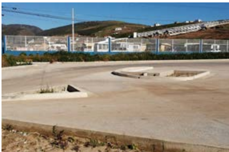
Estacionamiento No. 4 aeroespacial ubicado en el polígono sur con capacidad para 160 cajones, 30 motocicletas, 50 bicicletas y 8 cajones para discapacidad, tiene un avance del 30%, sin contemplar áreas verdes, iluminación, y caseta de control y vigilancia
