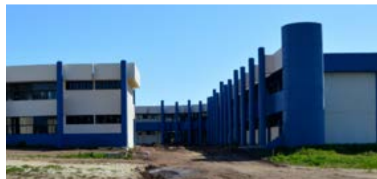
Explanada que integra el proyecto aeroespacial, muestra un avance del 20% en trabajos preliminares.
