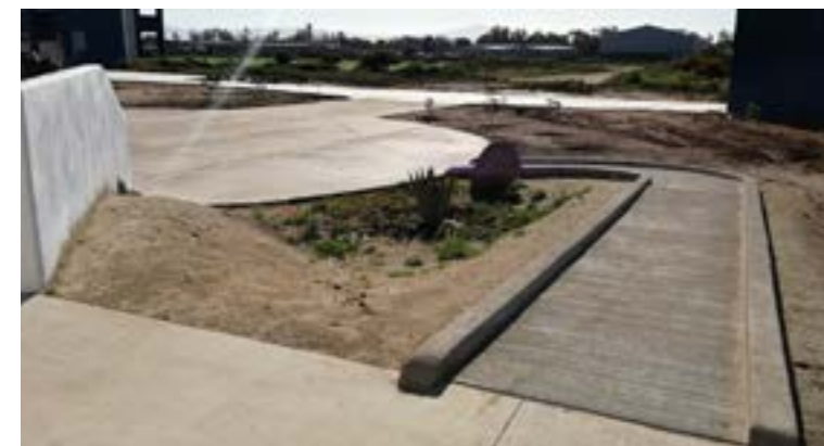
Banquetas, andadores y rampas que complementan y conectan con cada uno de los edificios del proyecto aeroespacial, registran un avance del 30%.
