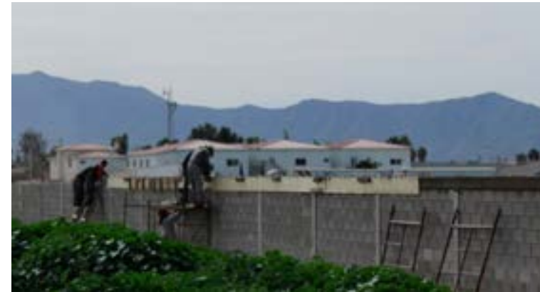
Barda perimetral de 350 metros lineales, construida con bloques y marcos de concreto ubicada en polígono sur, registra un avance del 70%.
